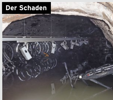
Der Schaden Der Keller im Altstadthaus mit den Verleihrädern war geflutet.
